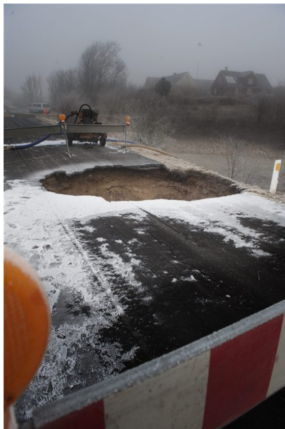
Et enormt hul på Hedegaardsvej mellem Vegger og Halkær har lukket vejen, indtil skaden er udbedret. Foto: Niels Meredin
